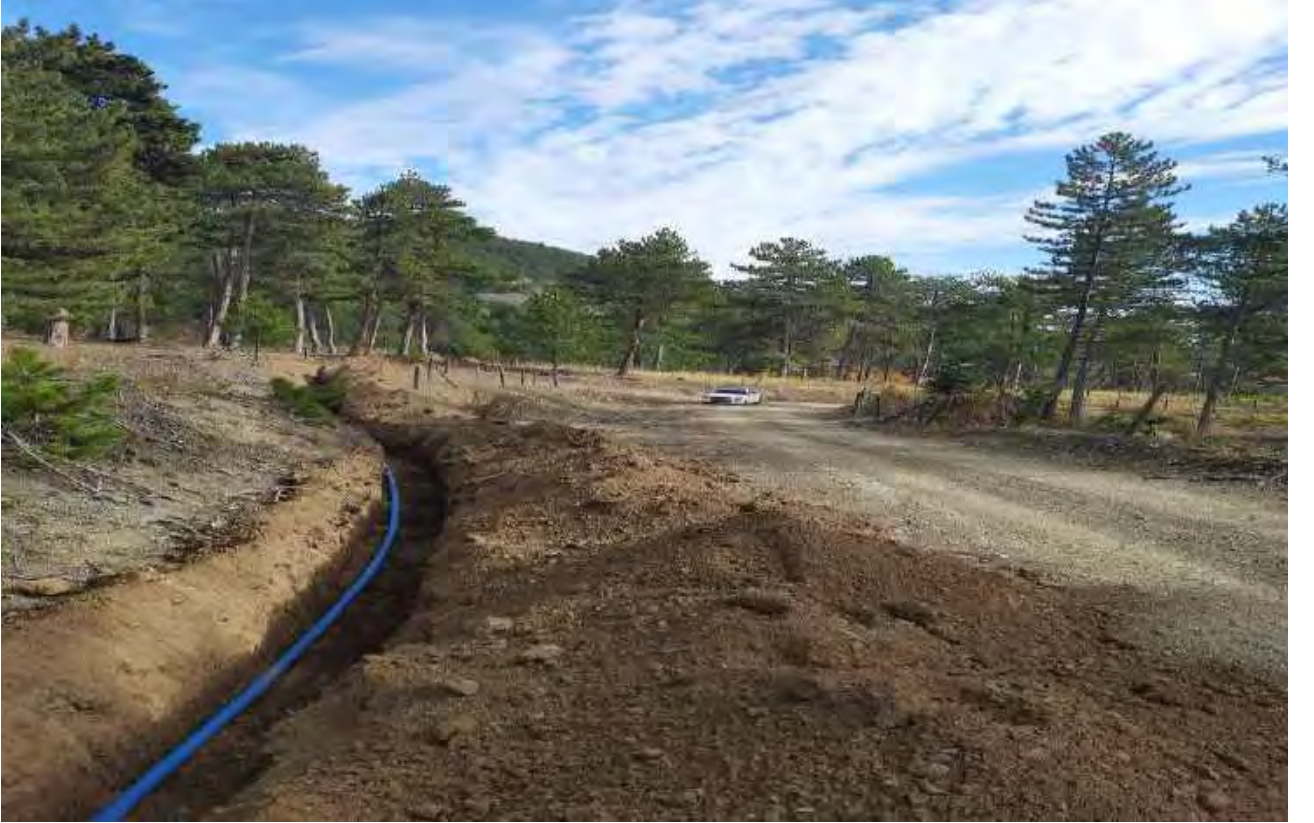
İskilip İlçesi Sorgun Köyü Karayanık Mahallesi İsale Hattı
