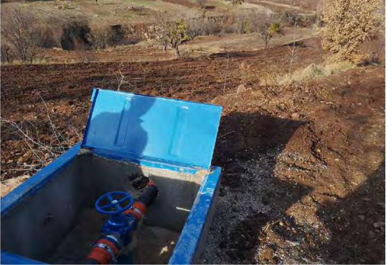
İskilip İlçesi Çatkara Köyü Yağmurlama Ve Damla Sulama Tesisi
