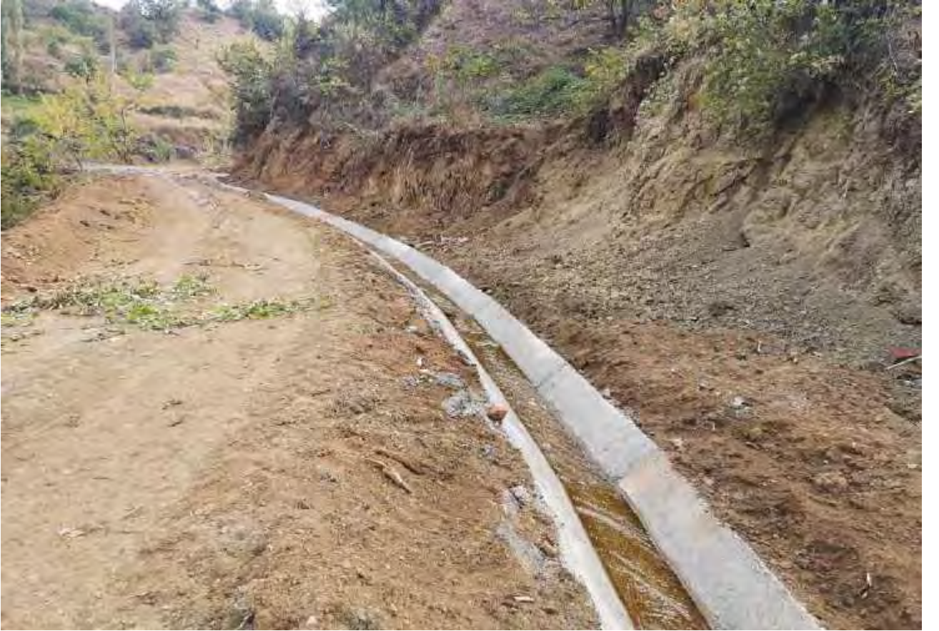
Dodurga İlçesi Dikenli Köyü Sulama Tesisi
