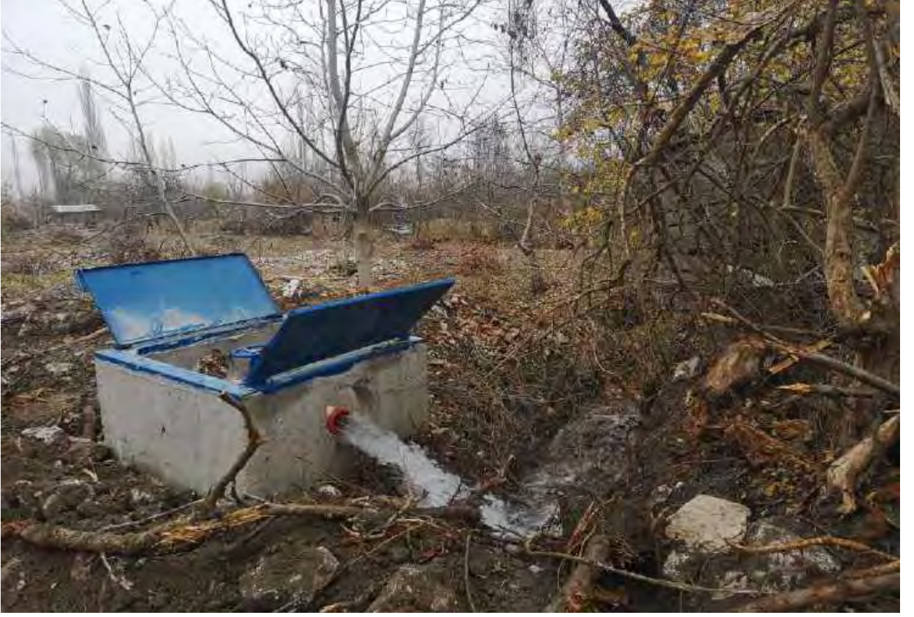
Mecitözü İlçesi Figani Köyü Havuzdan Damla Sulama Tesisi
