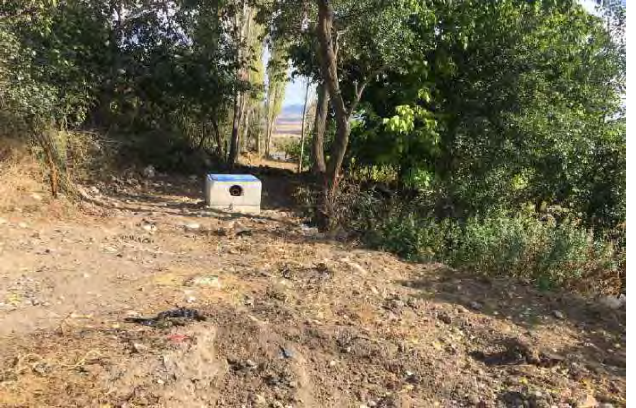
Merkez İlçe Taşpınar Köyü Havuzdan Damla Sulama Tesisi
